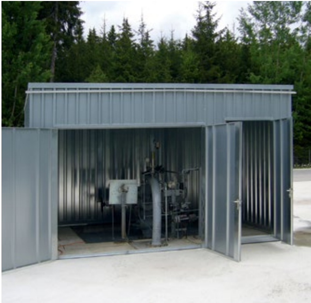
Einhausung von Gasförderanlagen
