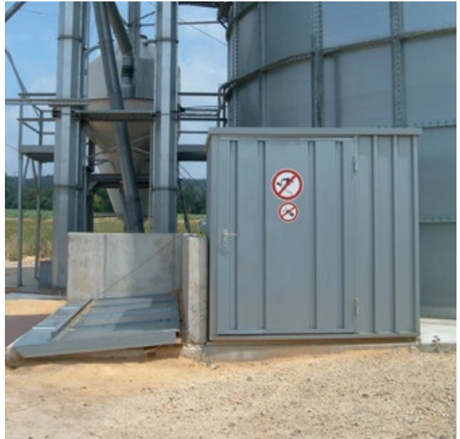
Einhausung für eine externe Schaltzentrale
